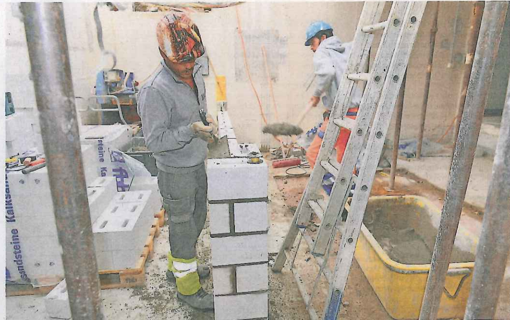
Hier sind die Maurer am Werk: Im Untergeschoss entsteht der neue Heizungs- und Elektroraum.
